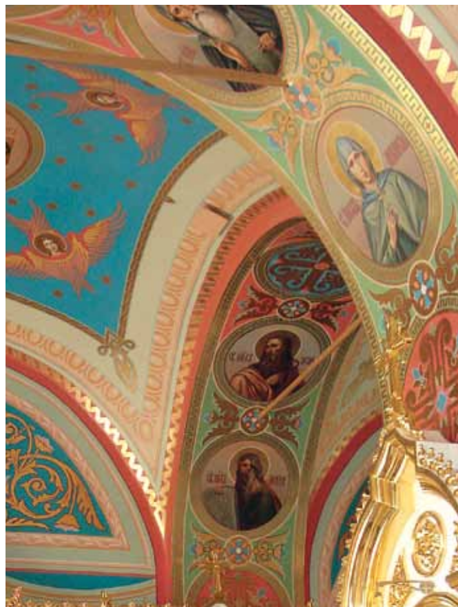
Вытяжное устройство, замаскированное под настенную роспись в верхней части свода арки
