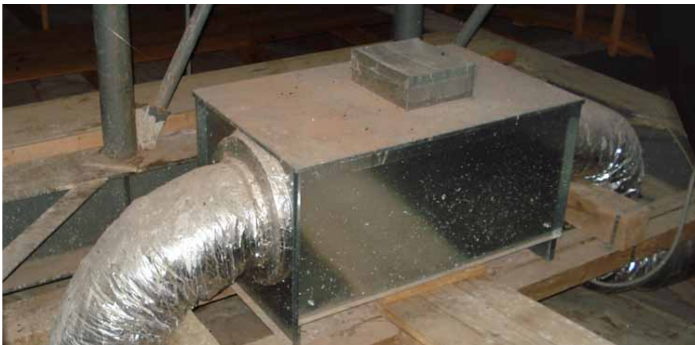
Центральный вентилятор, расположенный над трапезной храма
