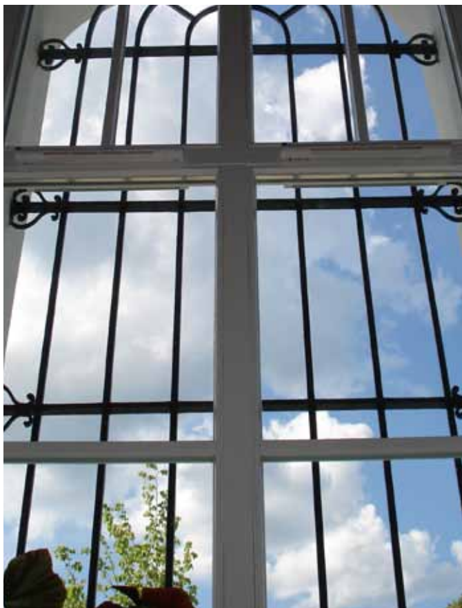
Приточные гигрорегулируемые устройства, установленные в верхней части окна.
