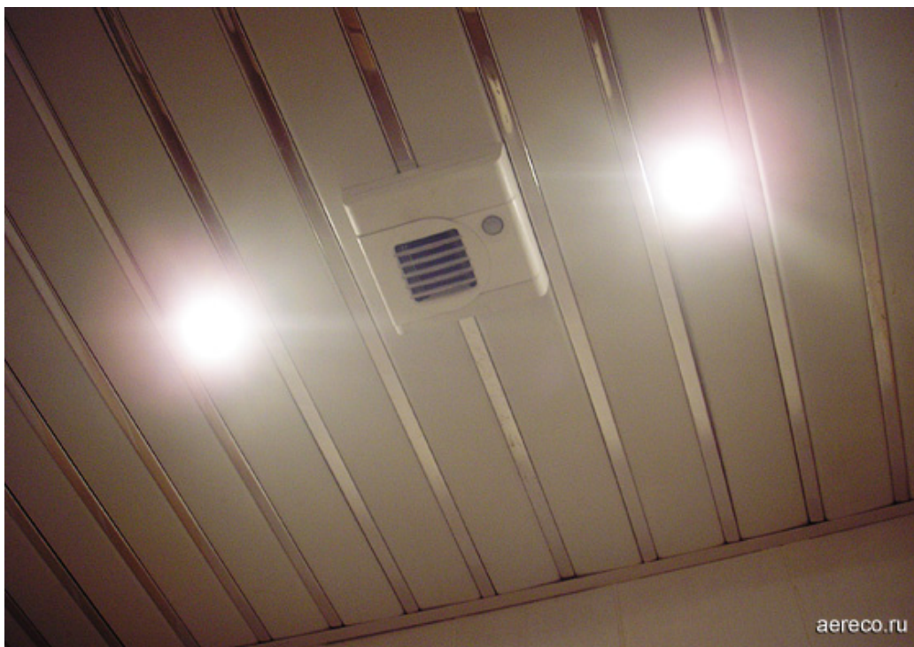
Установленное в санузле вытяжное устройство BXS с датчиком присутствия. Датчик присутствия позволяет активировать пиковый режим расхода воздуха.
