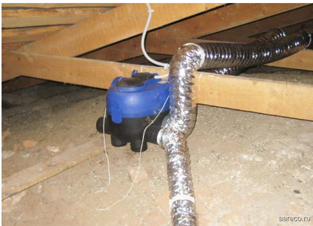
Вентилятор VPH 2 , закрепленный на поперечной балке чердачного пространства.
