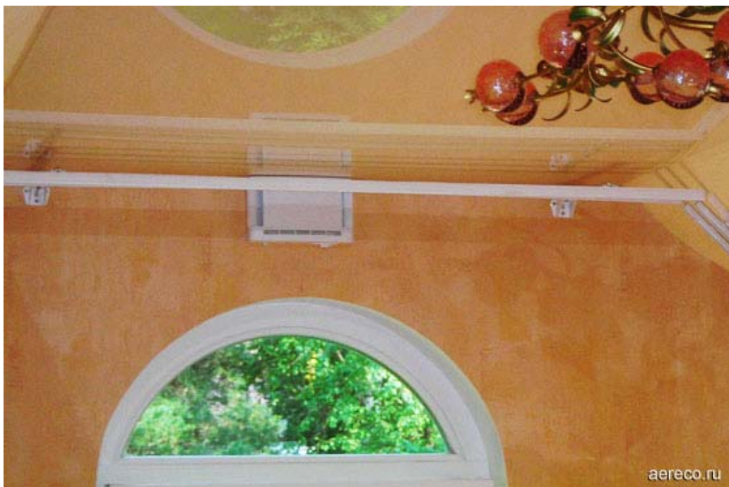
Стеновой приточный клапан ENT, установленный под натяжным зеркальным потолком.
