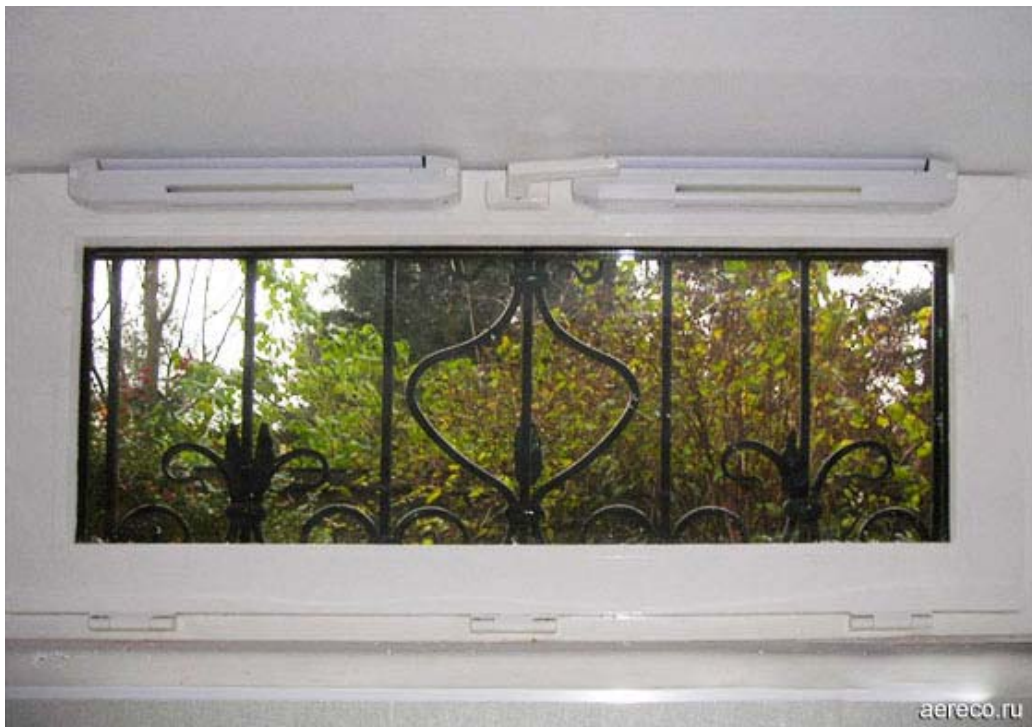
Два приточных оконных шумозащитных клапана ЕНА, установленные в верхней части окна и обеспечивающие приток воздуха в цокольный этаж коттеджа.
