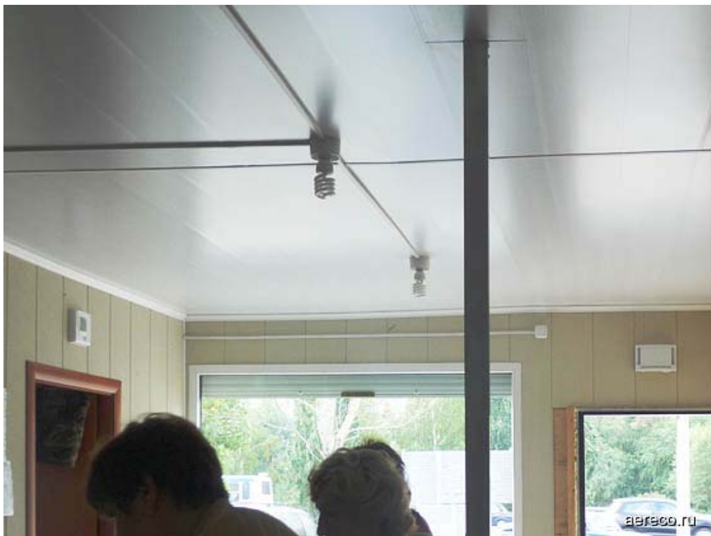
С правой стороны над дверью установлено стеновое приточное устройство ЕНТ. С левой стороны установлено вытяжное устройство ВХС с датчиком присутствия, обеспечивающее расход воздуха от 12 до 70 м 3 /ч при 100 Па.
