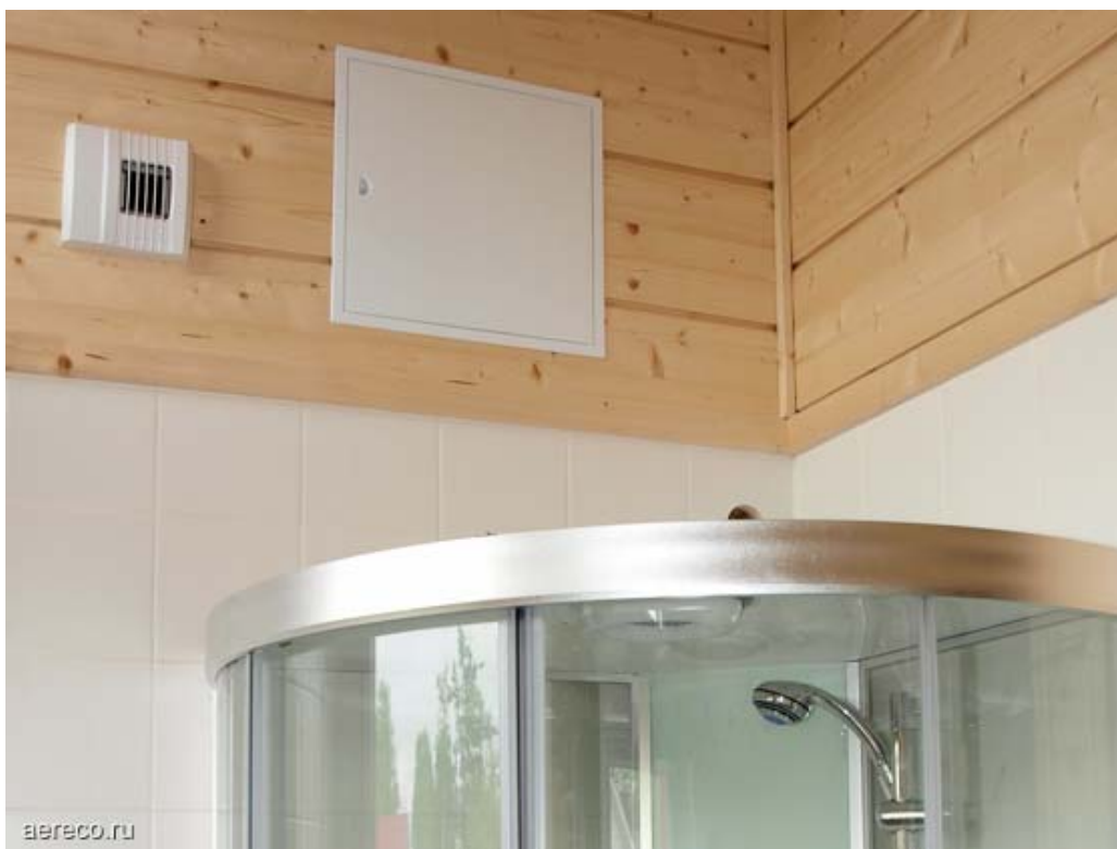
Душевая комната с установленным вытяжным устройством ВХС. Наличие ревизионного люка позволяет скрыть внутренние коммуникации и обеспечить доступ к вентилятору для технического обслуживания.
