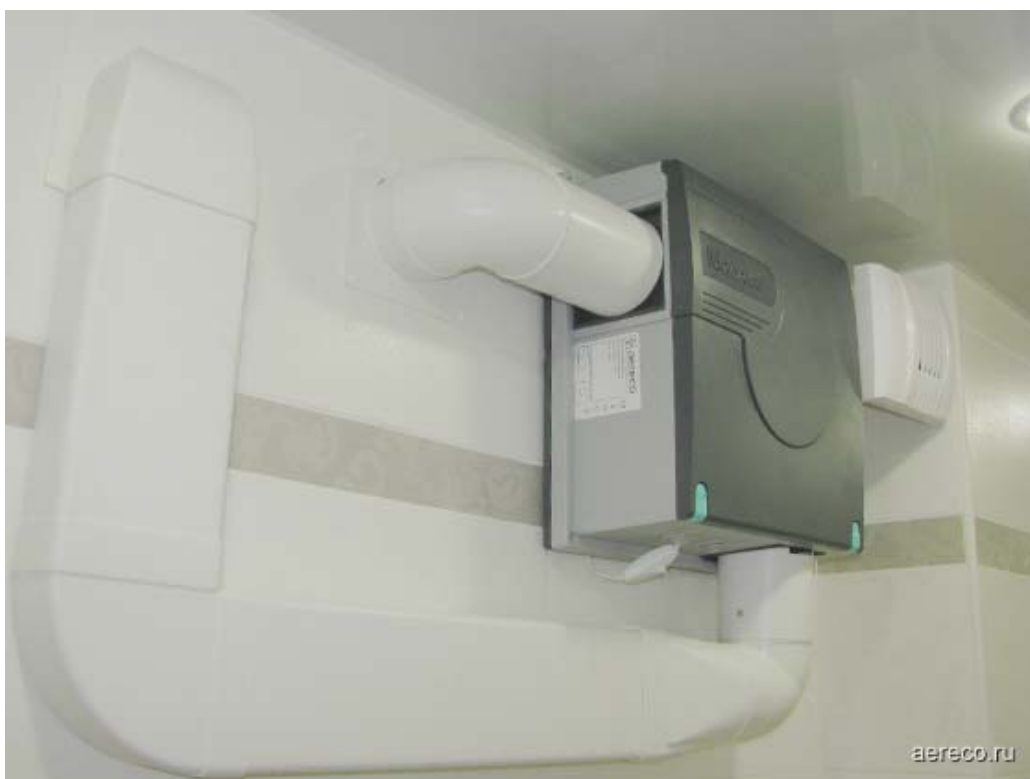
Установленный на стене вентилятор V2A с пластиковыми воздуховодами разного сечения и подсоединенным вытяжным устройством VXC.
