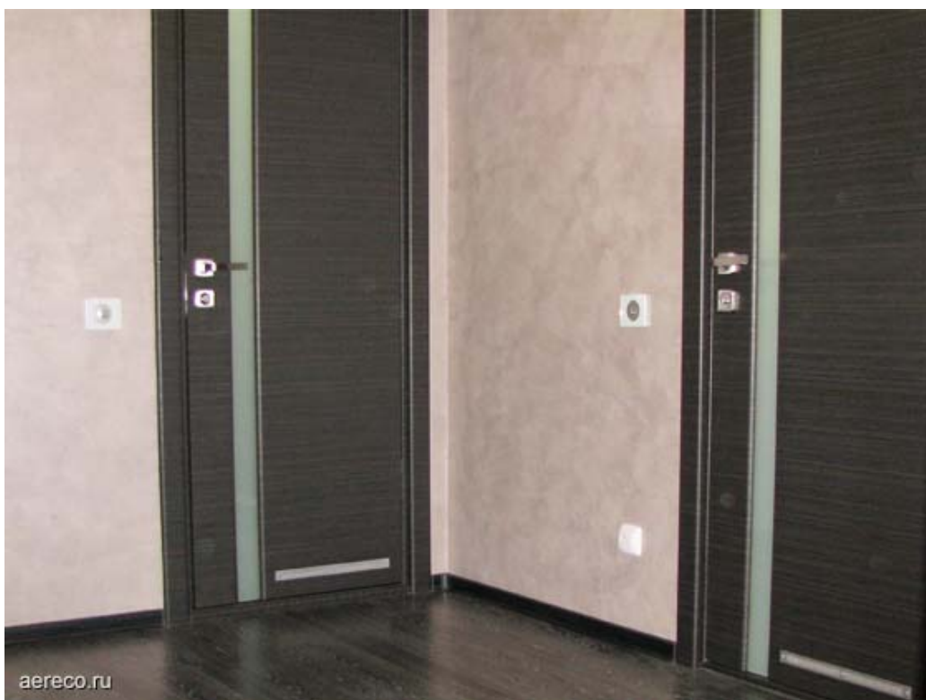
Переточные решетки, установленные в нижней части межкомнатных дверей.
