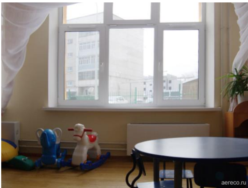
Типовой оконный блок с приточными клапанами Аересо, установленный в ясельной группе на первом этаже.
